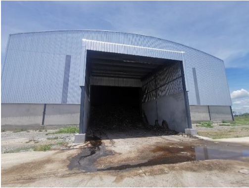
น้ำชะขยะบริเวณอาคารถ่ายเทขยะมูลฝอย
